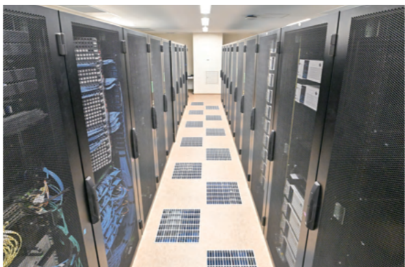
新病院のサーバ室。各種医療情報システム、事務系システム、統合データベース等を管理。セキュアなネットワーク環境の構築を実施している。
